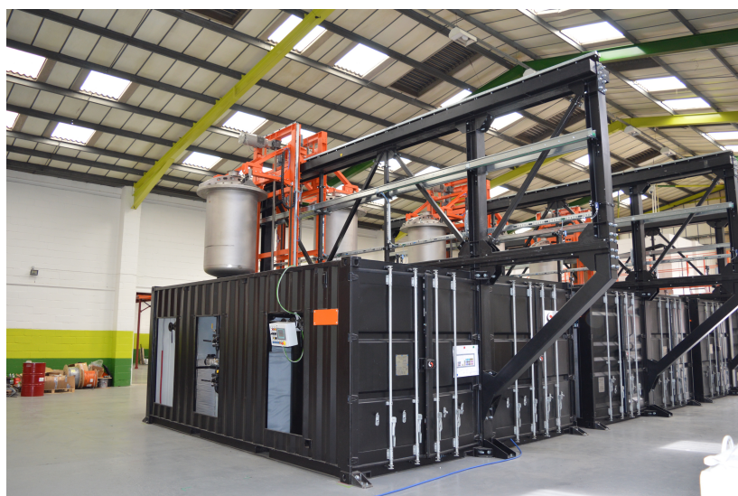
Obrázek 2.1: Pyrolýzní část linky TEVO - jednotka s jejími moduly a manipulačním jeřábem
