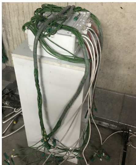
obr. 47: datalogger včetně napojení všech měřicích zařízení
