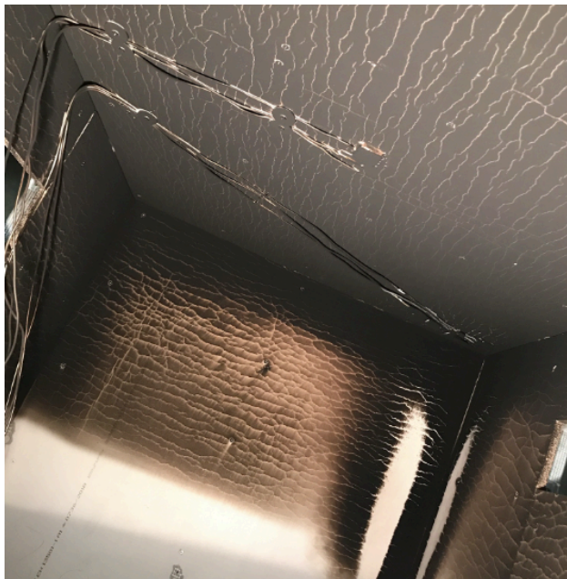
obr. 53: strop a stěny zkušební místnosti po skončení požárního experimentu
