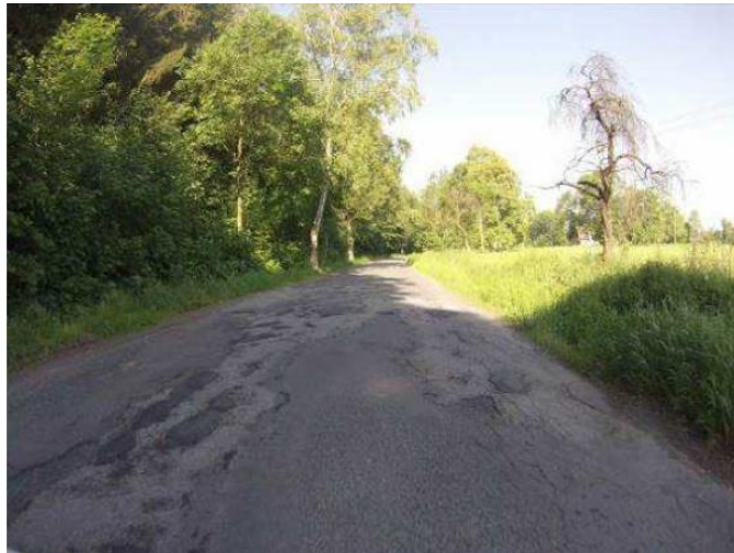
Obrázek 2.2 – Stávající stav v místě s hlubkovou korozí, výtluky, vysprávkami a mozaikovými trhlinami
