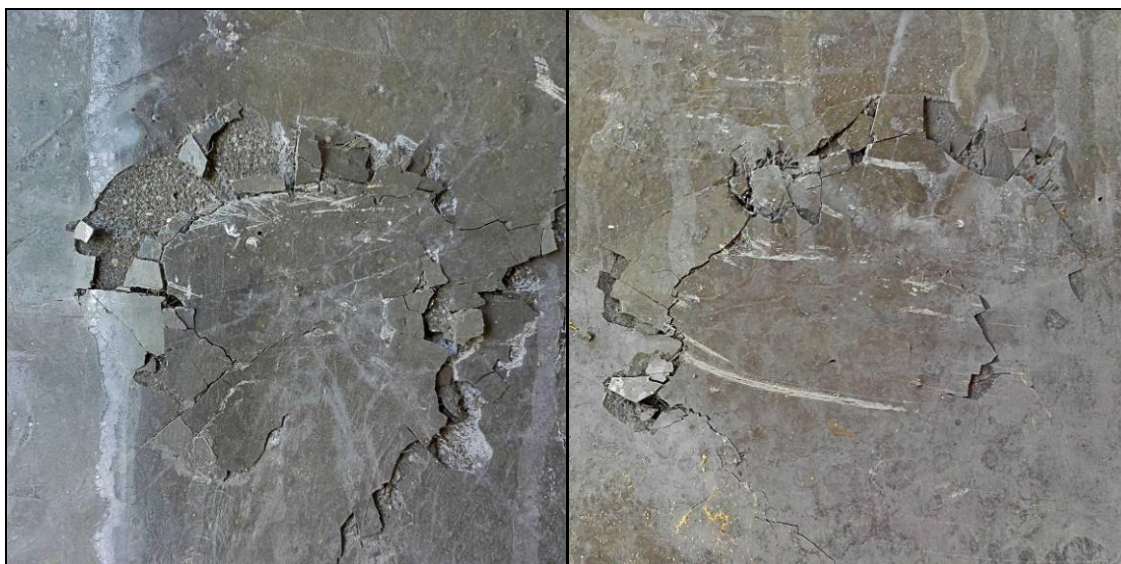
Obrázek 88: Poškození na zadní straně desky - vypuklina vzniklá scabbingem
