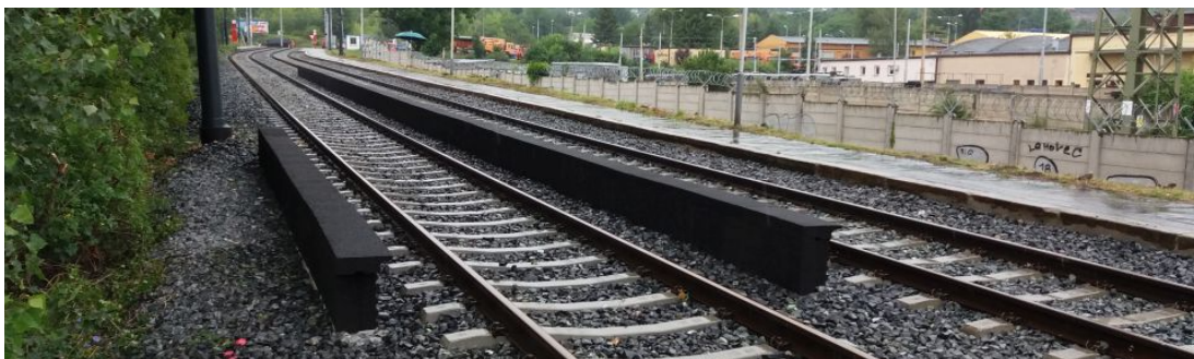
Obr. 13: Protihluková clona v Pražské části Hloubětín [12]
