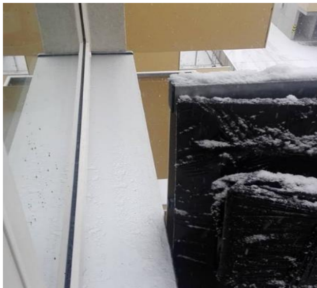
Obrázek 7: Chybně navržené zábradlí – realizace
