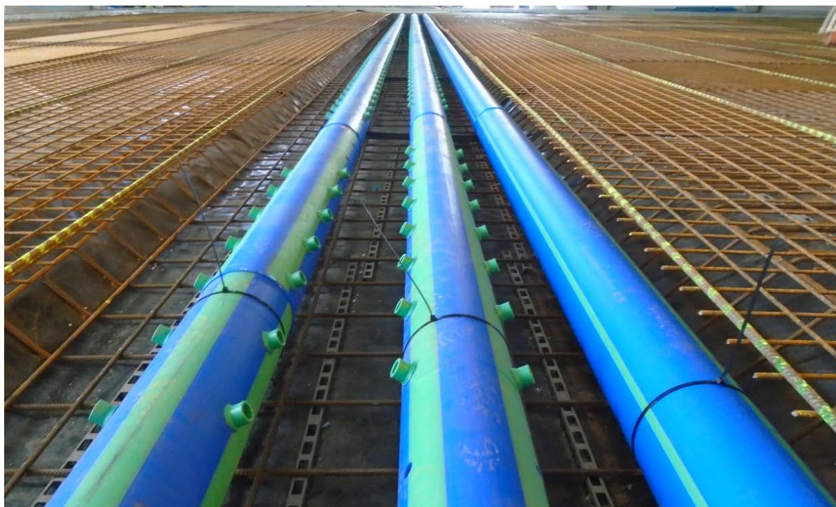
Obrázek č. 26 – Fotografie: trubní vedení v registru chlazení, Zdroj: PD
