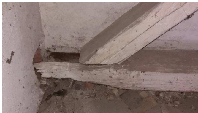
Obrázek 34 - Destrukce zhlaví vazného trámu VT2-B, místo odběru vzorku MV1
