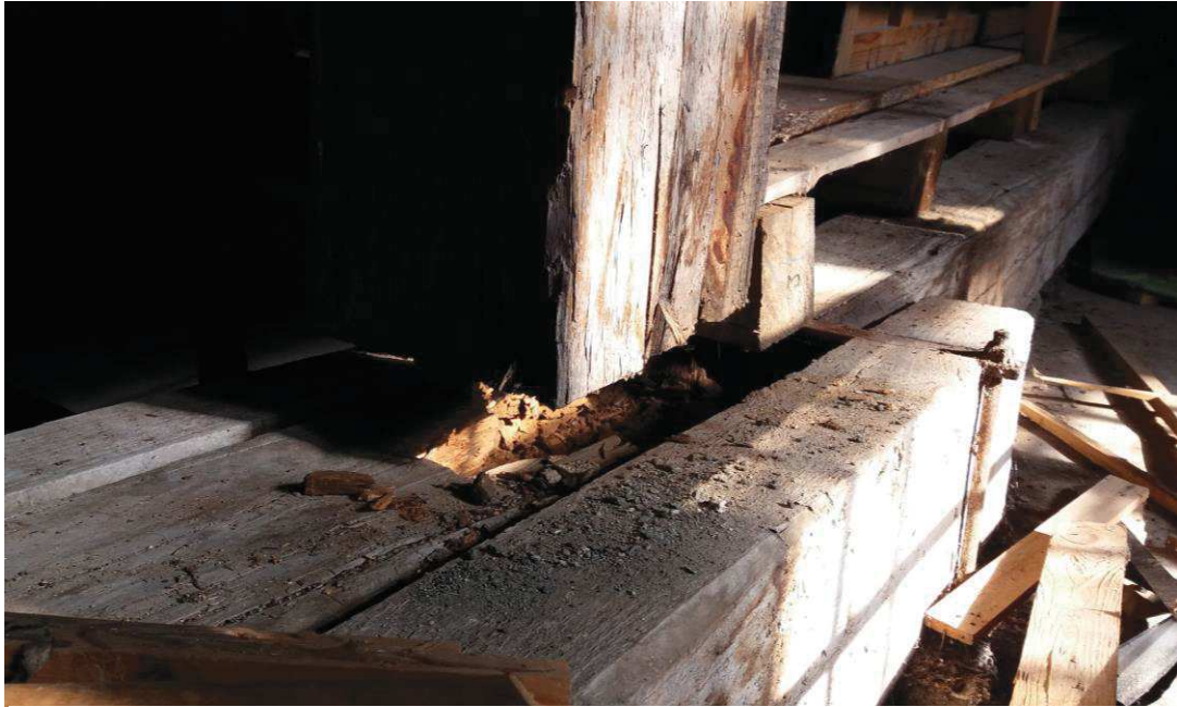
Obrázek 38 - Rozpad styku sloup - vazný trám, místo odběru vzorku MV2
