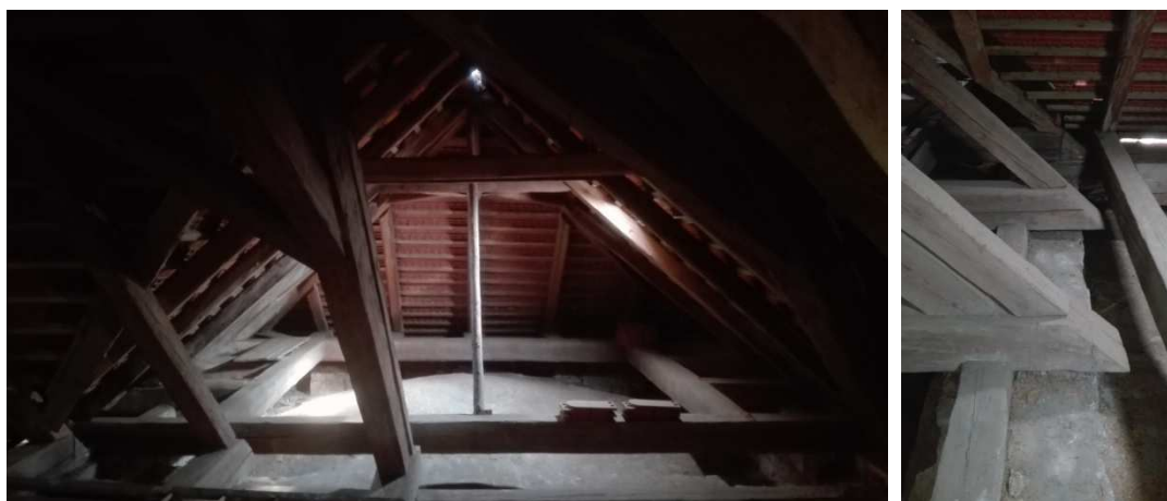
Obr. č. 67.; 68. pohled do krovu oratoře; konec vazeb hl. lodi u první vazby levé oratoře
