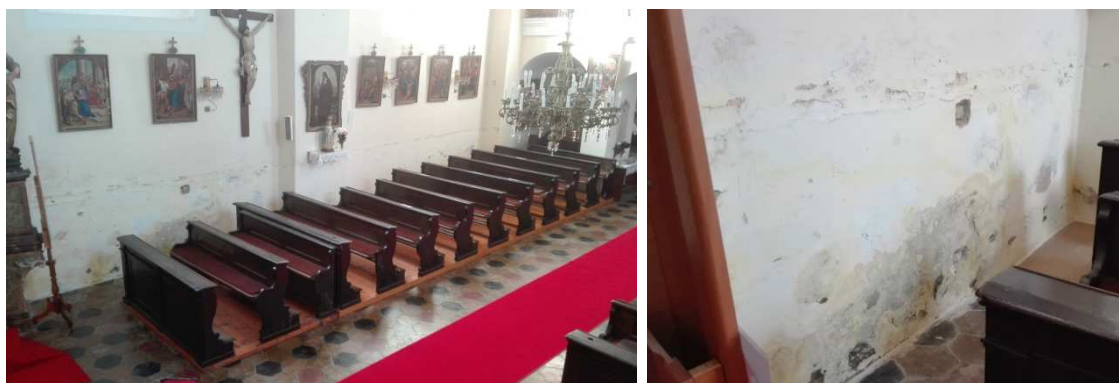
Obr. č. 25.; 26. poškození omítek po celé délce jižní zdi; růst mikroorganismů
