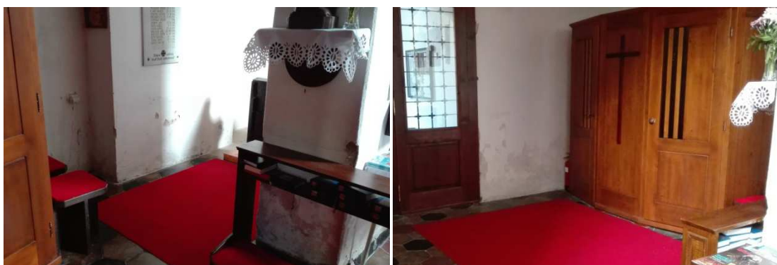
Obr. č. 23.; 24. poškození paty sloupu a rohu severní stěny za zpovědnicí; věžní stěna u zpovědnice
