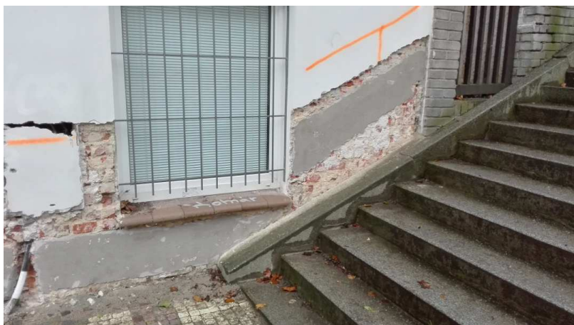
Obr. č. 89. vyrovnávací malta před osazením anody, foto z instalace firmy Prins na domě v ul. Slávy Horníka 39 - Košiče
