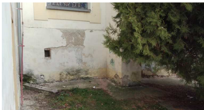
Obr. č. 14. jižní fasáda presbytáře za tiseň
