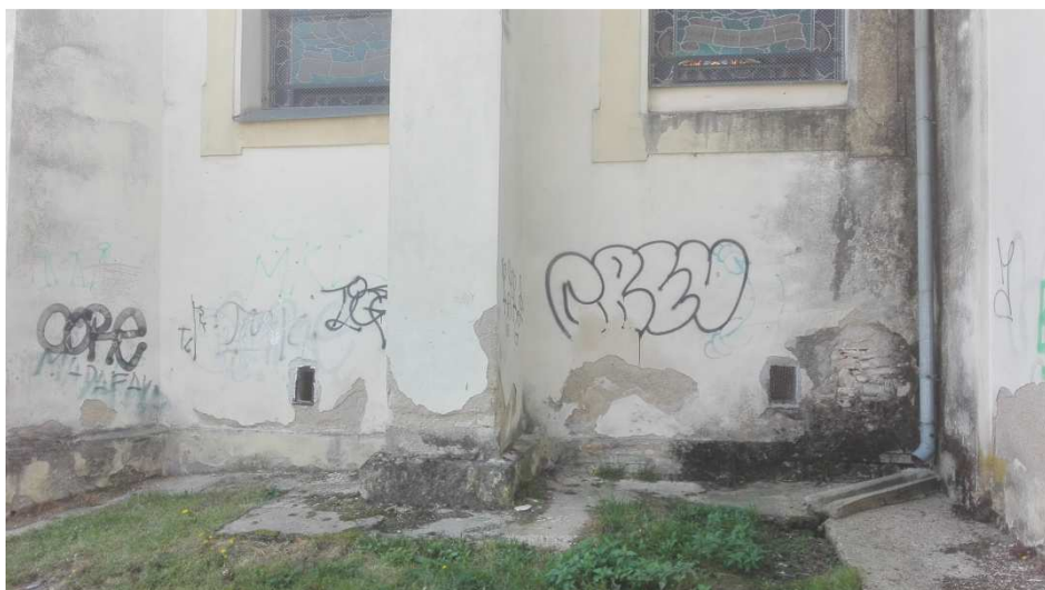
Obr. č. 86. pohled na severní stěnu presbytáře, viditelné větrací otvory a betonový žlab na odvod dešťové vody
