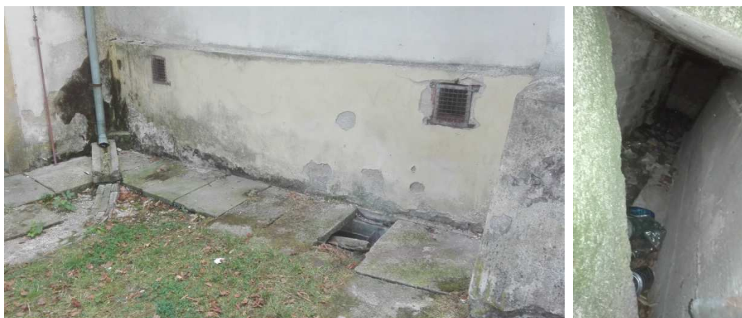
Obr. č. 83; 84. prostor mezi 1. opěrákem a oratoří na severu s propadlou krycí deskou žlabu; pohled do větracího žlabu
