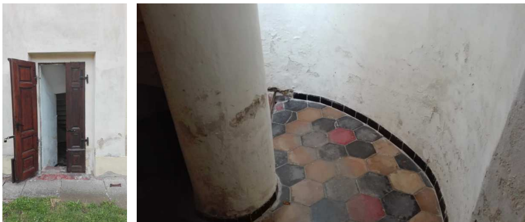
Obr. č. 45.; 46. vstupní dveře; Poškozené středové vřeteno a zeď
