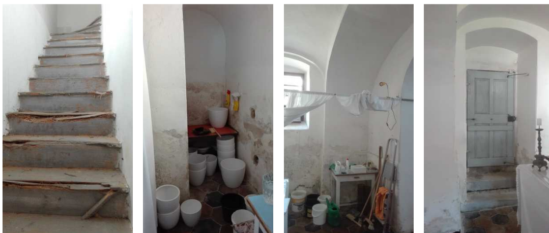
Obr. č. 41.; 42.; 43.; 44. značně poškozené schody do patra pravé oratoře; výklenek pod schody pravé oratoře; západní stěna pravé oratoře; dveře ve východní stěně pravé přístavby
