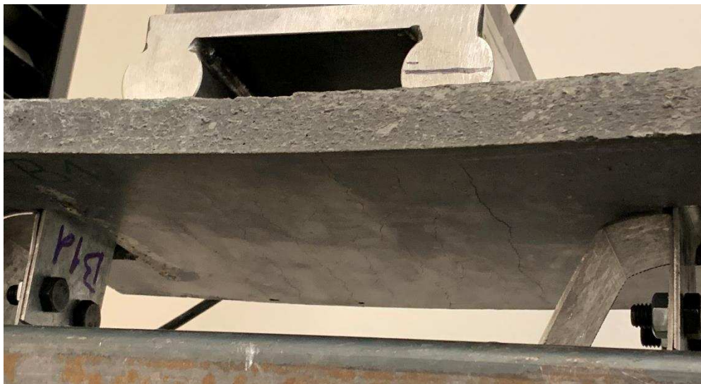
Obr. 95: Rozvoj trhlin ve spodní části desky
