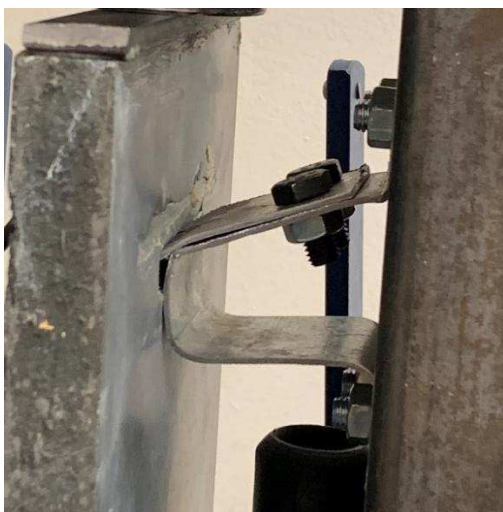
Obr. 79: Rozvinutá deformace horní kotvy
