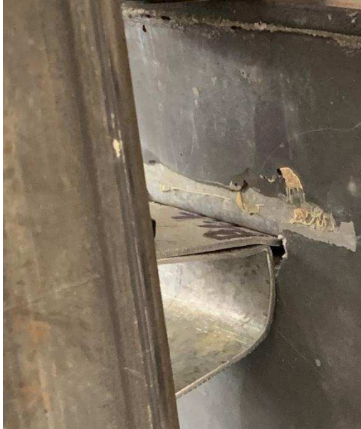
Obr. 77: Deformace háku u horní kotvy
