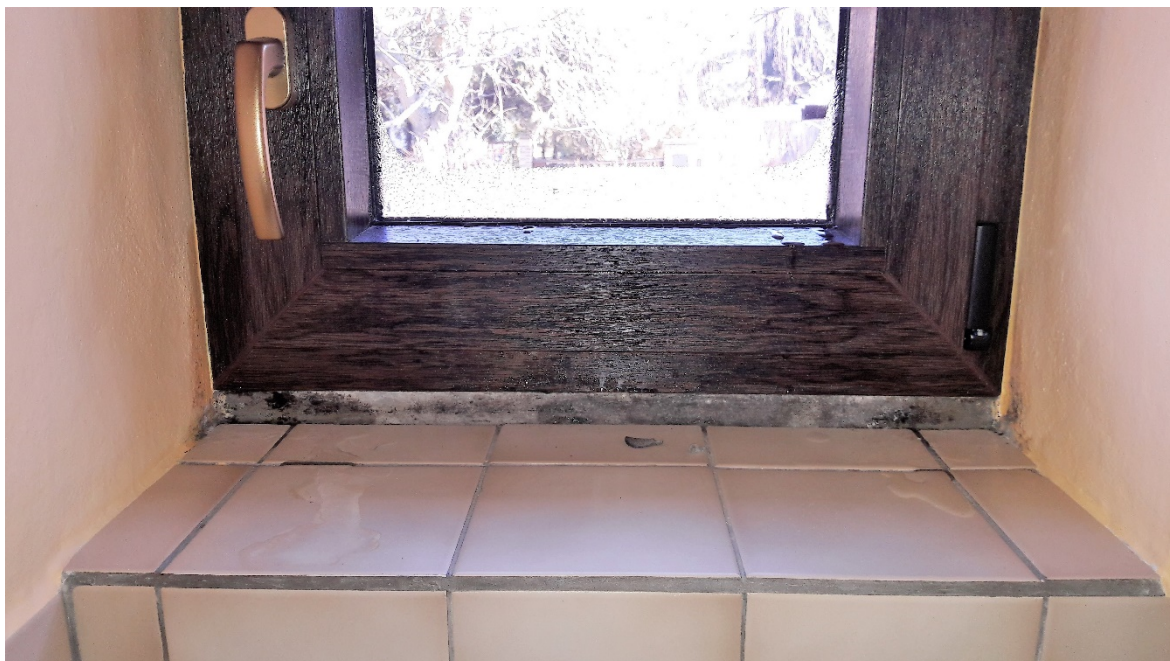
Obrázek 20 - Příklad okenní výplně s kondenzací v oblasti zasklívací i připojovací spáry [Foto: autor]
