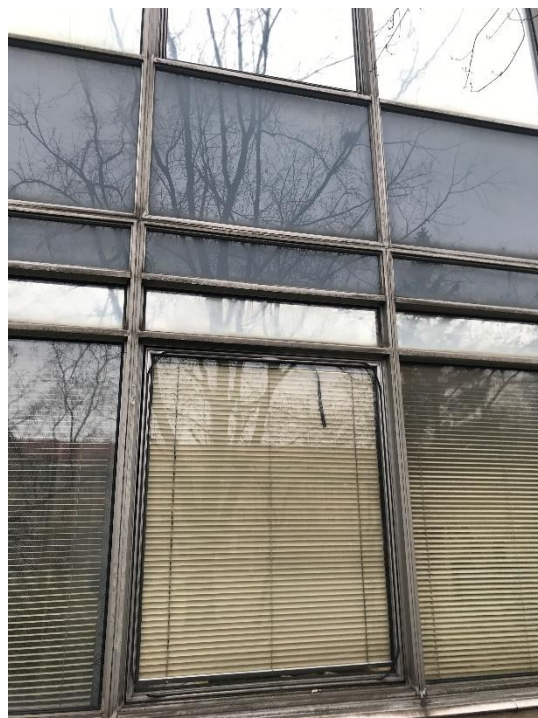
Obr. 11 Chátrající stav fasády [17]
