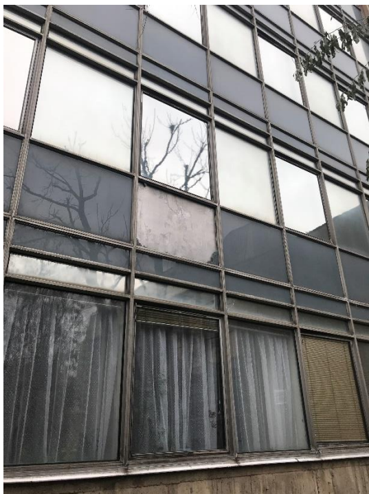
Obr. 10 Prasklé smaltované sklo v parapetním panelu na JV fasádě [17]
