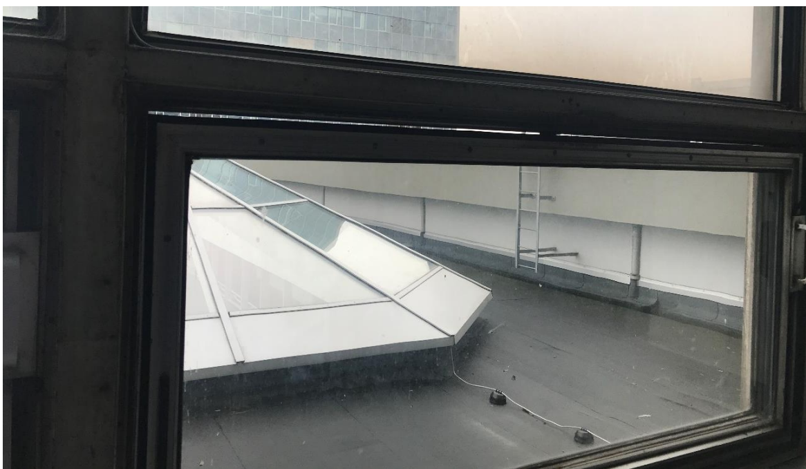
Obr. 12 Mezera mezi okenní výplní a rámem okna na SV fasádě [17]
