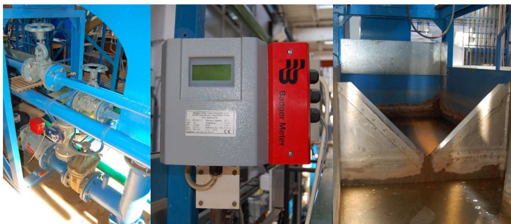
Obrázek 8 Ventily s osazeným průtokoměrem (vlevo) , Vyhodnocovací jednotka průtokoměru (uprostřed) , Thomsonův přeliv (vpravo)
