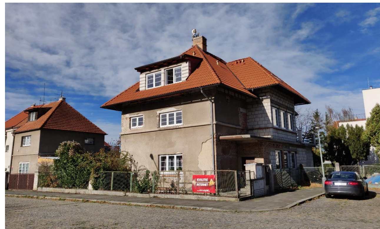
Obrázek č. 55 – Příklad nevhodného tvaru zastřešení s přesahem, autor: Miroslav Preclík
