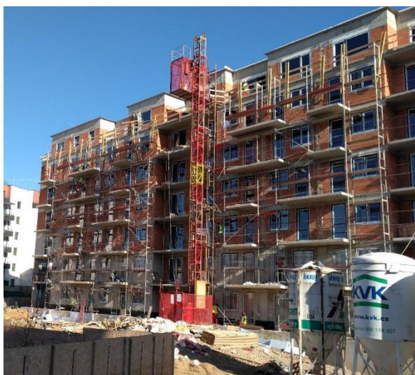
Obr. č. 15: Stavební výtah. [autor]
