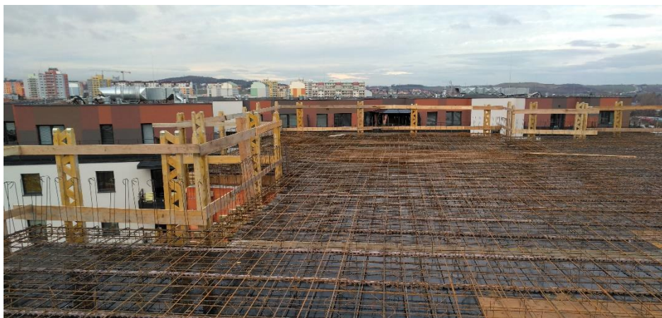
Obr. č. 12: Pevné zábradlí kolem celého objektu s výškou min 1,1m. [autor]
