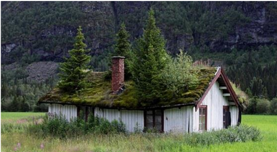
Obrázek 25: Zanedbání údržby zelené střechy [22]
