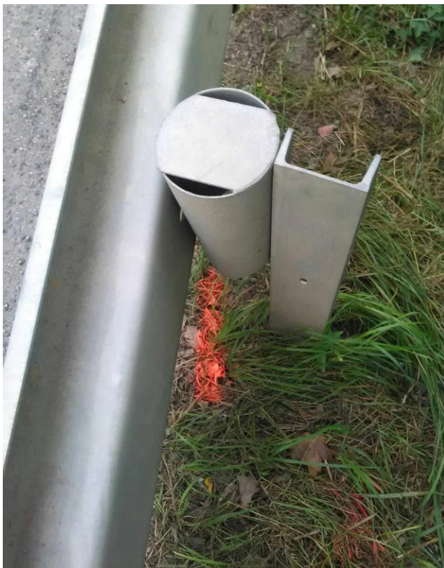
Obrázek 22 Kolize kabelu kVN 22 kV se svodidlem
