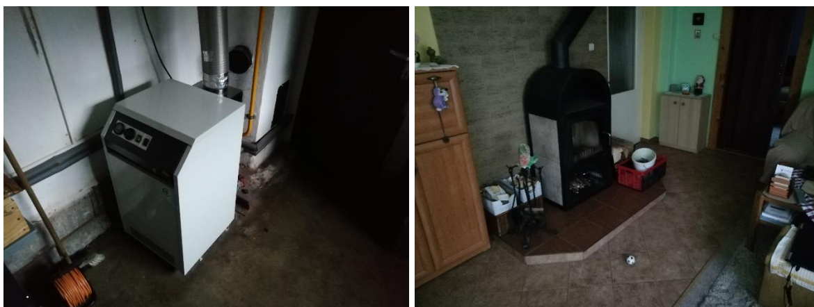
Obr. 17: Technické zařízení rodinného domu.
