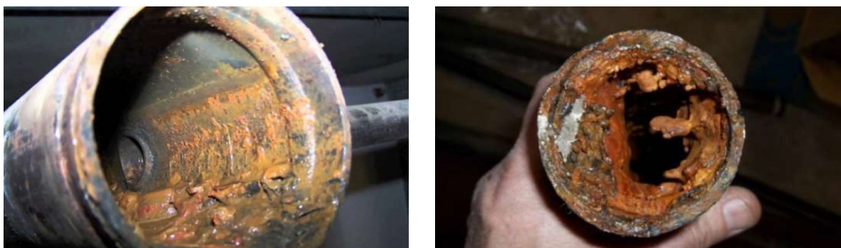
obr. 24 – Potrubní rozvody sprinklerových soustav zasažené korozí [28, 29]
