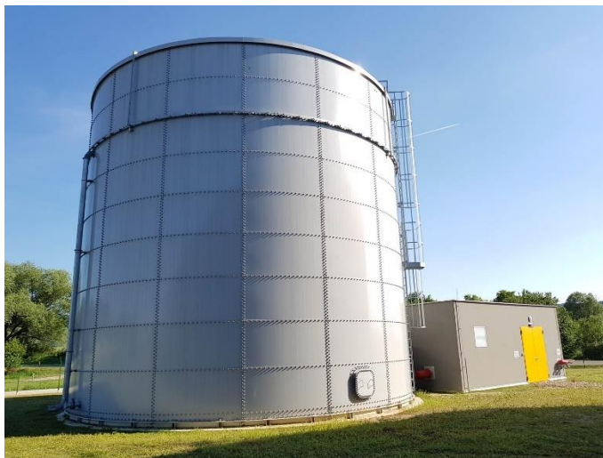
obr. 6 – Šroubovaná ocelová nadzemní nádrž a železobetonová konstrukce strojovny SHZ (kohimex.cz)
