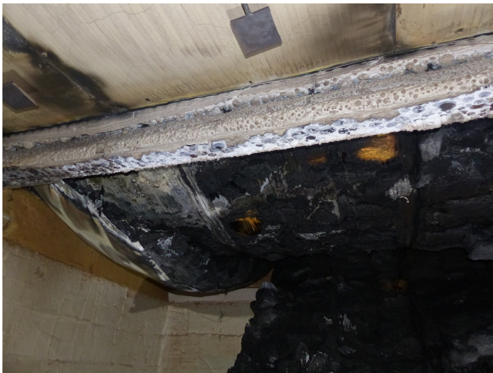
obr. 36 Pohled z pece na vyhořelý sendvičový panel
