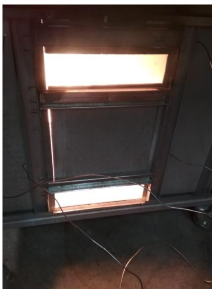
obr. 55 Netěsnosti v konstrukci pece
