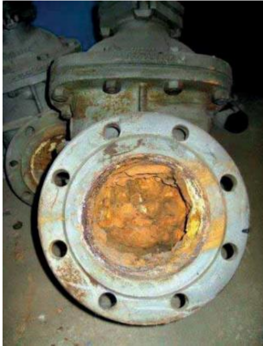
Obr. 20 Rezavý stav hlavního uzavíracího šoupátka [3]
