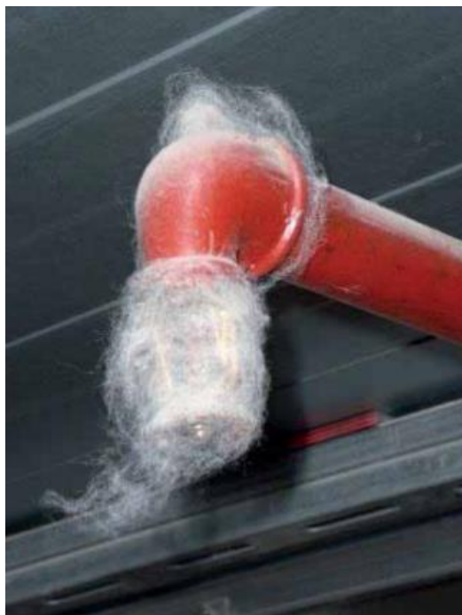
Obr. 21 Sprinkler zanesený vlákny bavlny [3]
