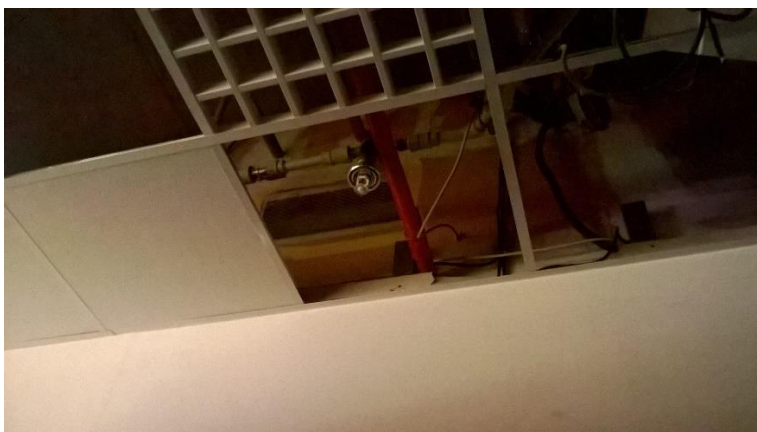
Obr. 9 Rozvod SHZ se závěsnými sprinklery v připraveném podhledu
