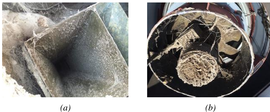
obr. 18 Zanesené potrubí VZT: (a) potrubí; (b) ventilátor [27]
