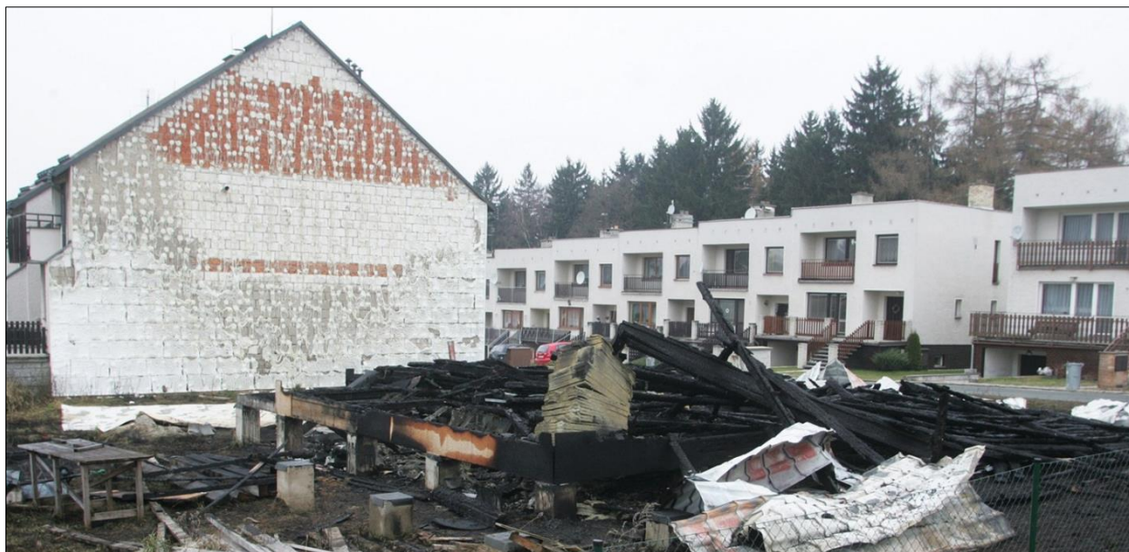
obr. 4 - Porušení KZS od požáru sousední dřevostavby [22]
