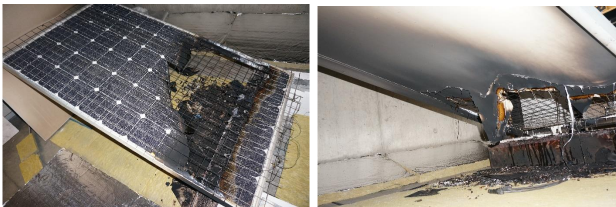
Obr. 23 Poškození přibližně 40 % plochy FV panelu
