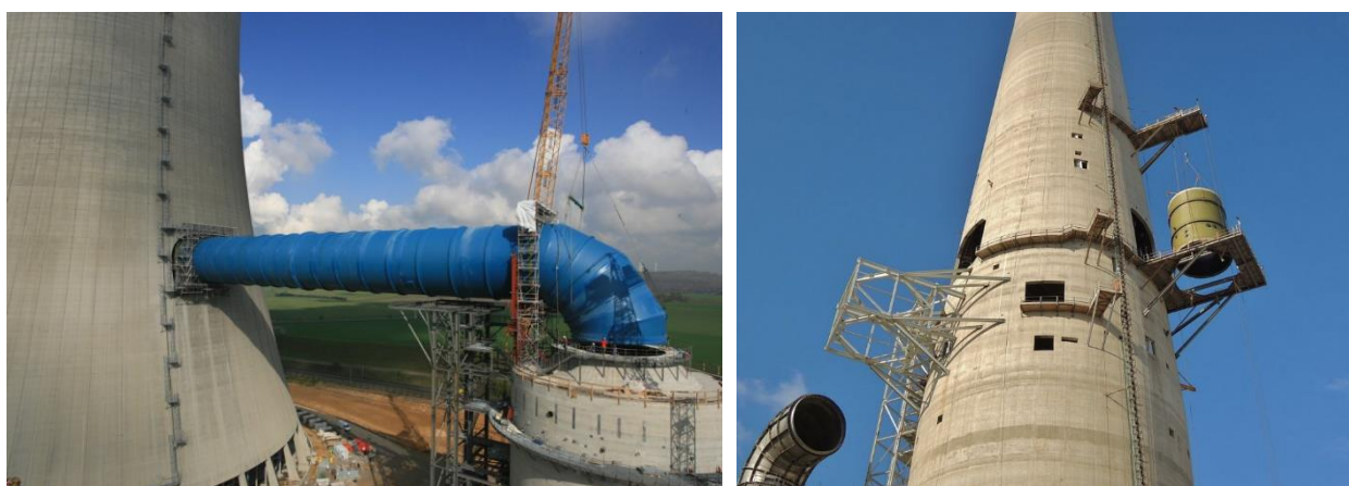
obr. 27 Využití kompozitních komínů v uhelných elektrárnách [30]
