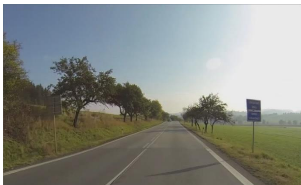
Obrázek 21: Absence zpevněné krajnice (staničení 128,536 km)
