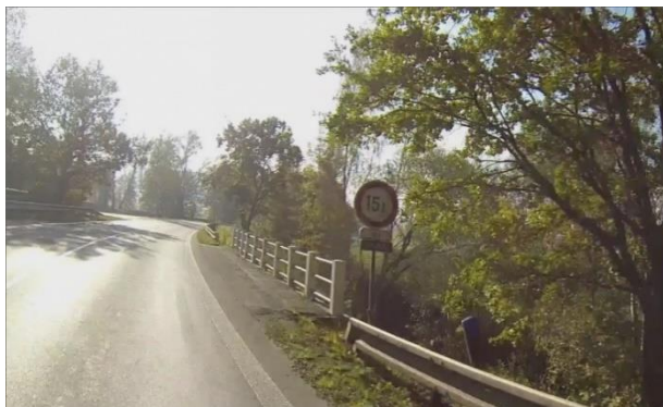
Obrázek 5: Krátký výškový náběh svodidel a nevhodný typ zádržného zařízení (staničení 140,735 km)
