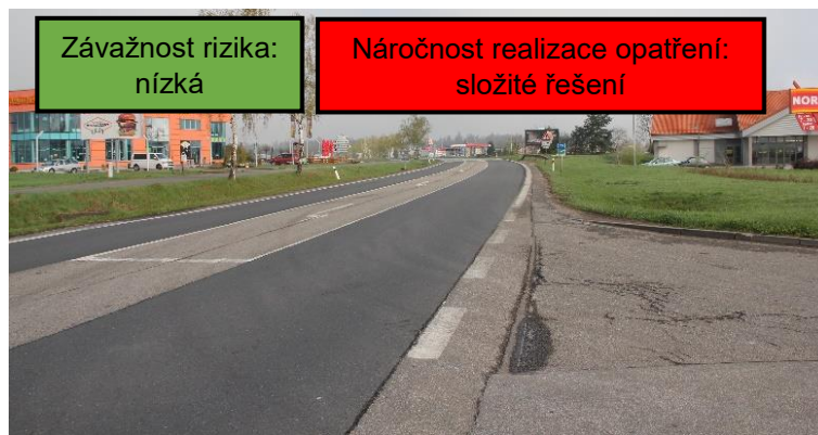
Obrázek 52: Mozaikové trhliny (NL Protivín)
