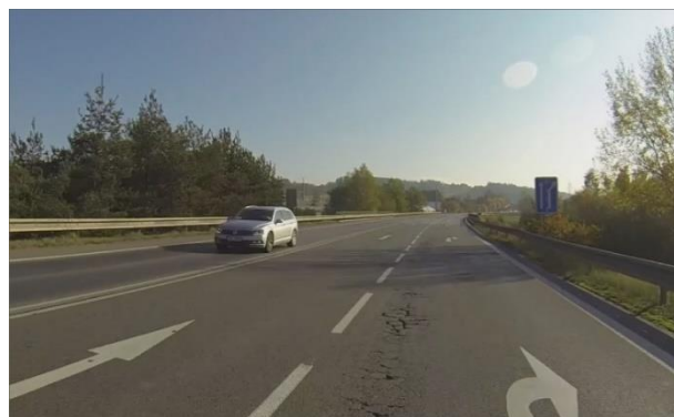
Obrázek 22: Mozaikové trhliny (staničení 165,112 km)
