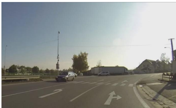
Obrázek 17: Absence osvětlení, prvků pro OOSPO, SDZ nebo dopravního zařízení, nedostatečná návaznost na chodník, dlouhý nedělený přechod pro chodce (staničení 138,510 km)
