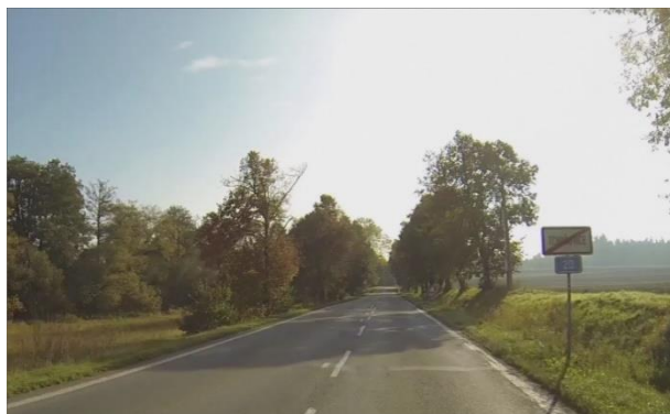
Obrázek 10: Absence nebo opotřebované VDZ (staničení 133,538 km)
