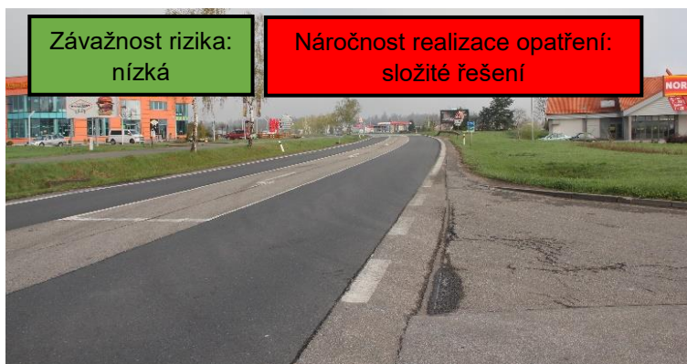
Obrázek 97: Mozaikové trhliny (NL Pištín)
