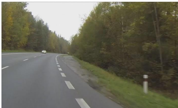
Obrázek 11: Neadekvátní provedení, resp. Umístění VDZ (staničení 176,862 km)
