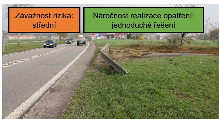
Obrázek 48: Neopodstatněně umístěné svodidlo (NL Protivín)
