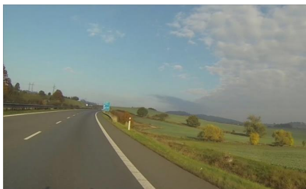
Obrázek 23: Nenormový svah zemního tělesa (příliš příkrý) (staničení 157,485 km)
