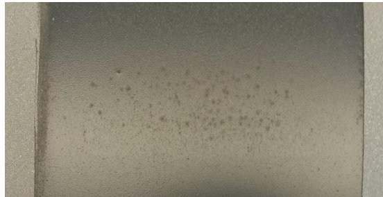
Obr. 27: Vady epoxidového nátěru na zamaštěném povrchu (vzorek EA-M2)
