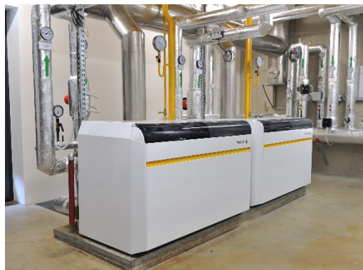
OBRÁZEK 3 PLYNOVÉ KOTLE 2X108 KW
