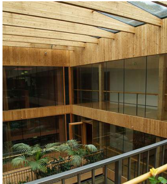
obvodová chodba s prosklenou fasádou - nevhodné řešení
