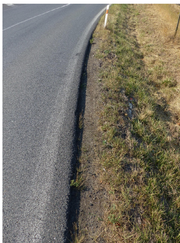
Obrázek 4 – Místo vyježděné nezpevněné krajnice a vytržený směrový sloupek, zdroj: autor
