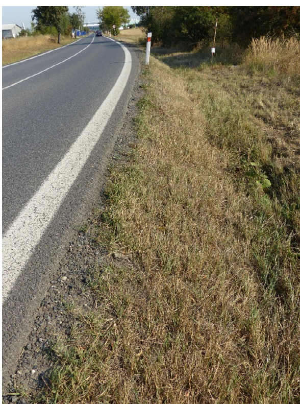
Obrázek 3 – Prudký svah násypu a chybějící nezpevněná krajnice, zdroj: autor
