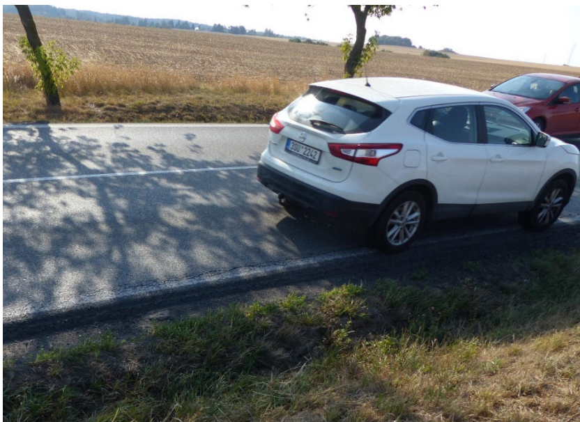
Obrázek 1 – Ukázka nerespektování poloměrů směrových oblouků řidiči a začínající trhliny krytu u okraje vozovky, zdroj: autor
