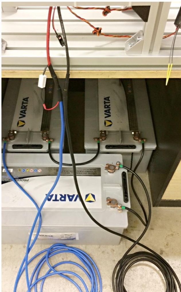
Obr. 38 - Pohled na zapojení baterií a měřícího přípravku
