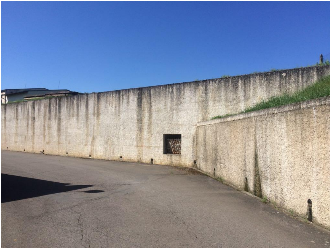
Opěrná zed' - ochrana podniku před povodní
