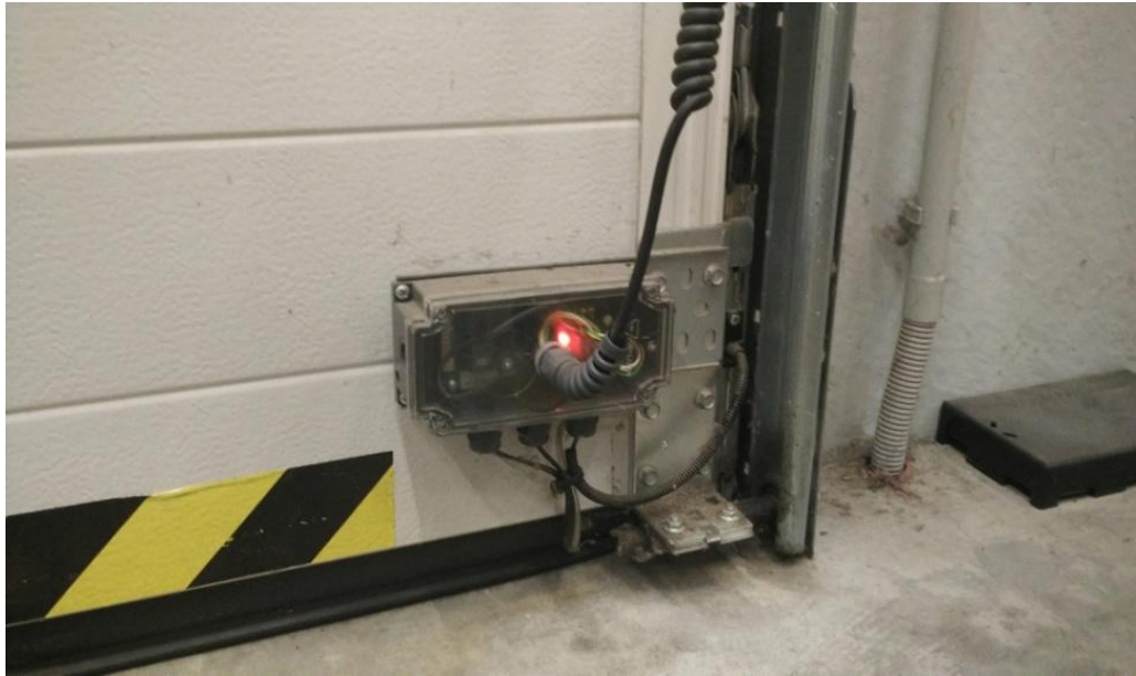
Obrázek 7 - Systém alarmu na vratech (Zdroj: autor)
