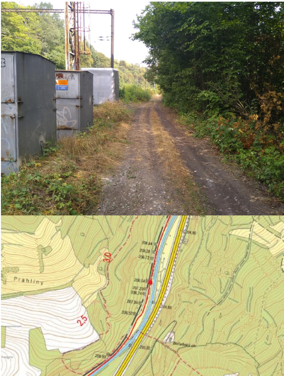
Obrázek 10 - Fotografie se zařízením pro železniční trať, [4], [vlastní zpracování]
