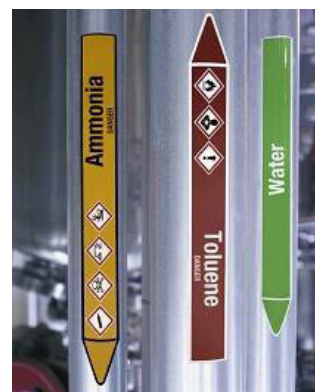
Obrázek 28 - barevné značení potrubí
