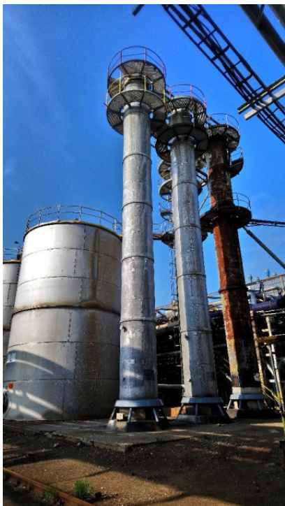
Obrázek 42 - Hydrolyzační věže (stará, zkorodovaná) slouží už jen jako podpora potrubí a lávky.
