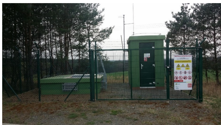
Obrázek 29 - stanice aktivní katodické ochrany ropovodu
