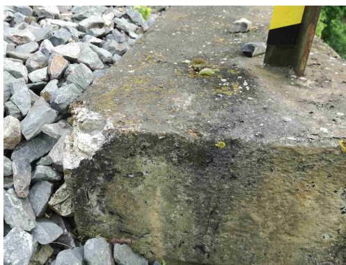
Obr. 14: Odštípnutá část římsy
