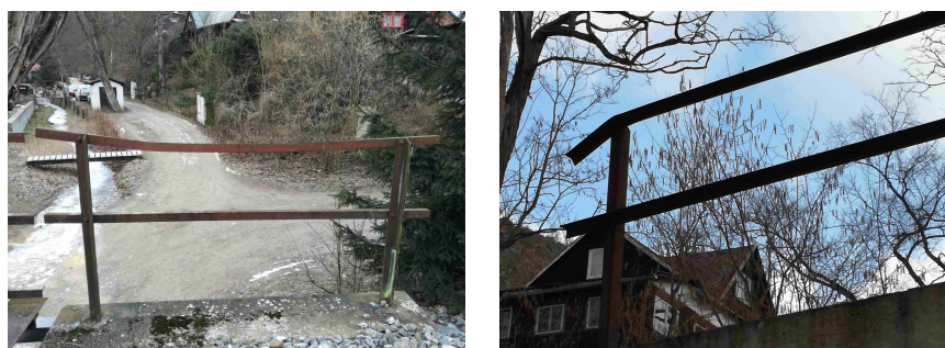
Obr. 20: Zdeformovaná madla krajních zábradlí
