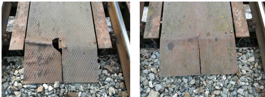
Obr. 17: Praskliny na podlahovém plechu mezi vnitřními nosníky
