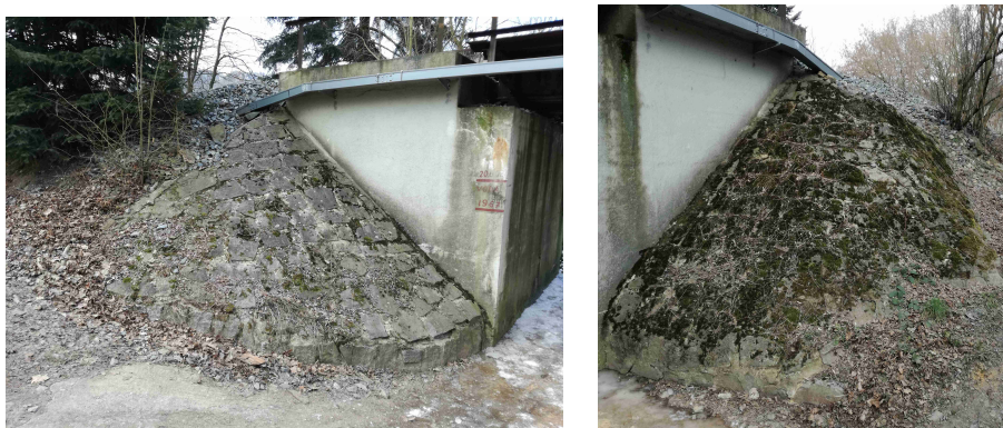
Obr. 15: Svahové kužele na pravé straně mostu porostlé vegetací
