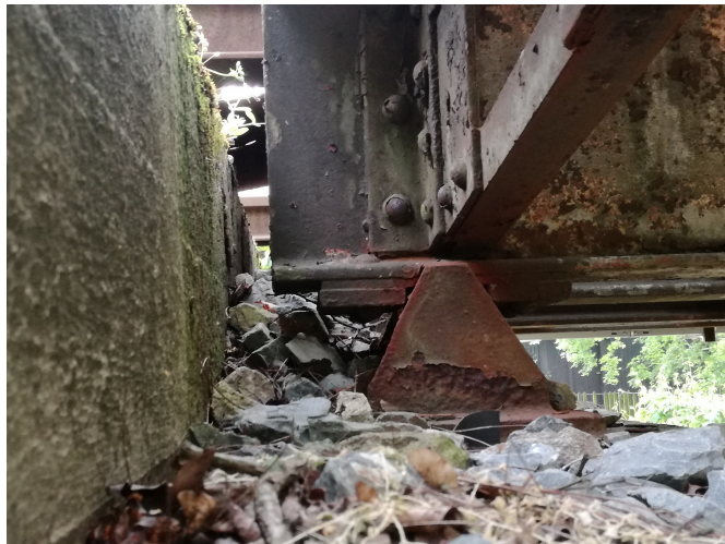
Obr. 6: Pevné ložisko na opěře O 01
