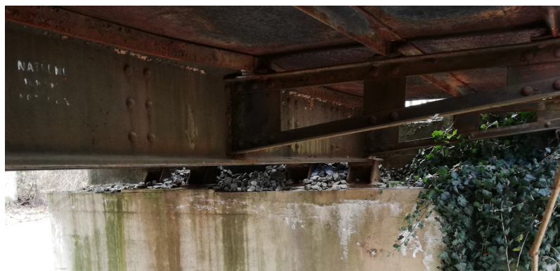
Obr. 16: Zanesená ložiska na opěře O 01 od šterku z kolejového lože
