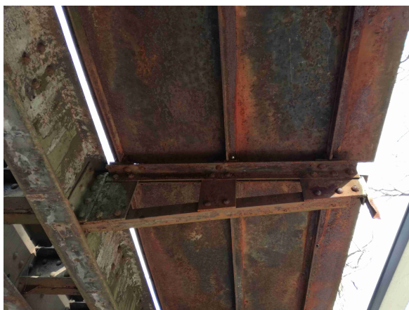
Obr. 18: Projevy koroze na chodníkových konzolách
