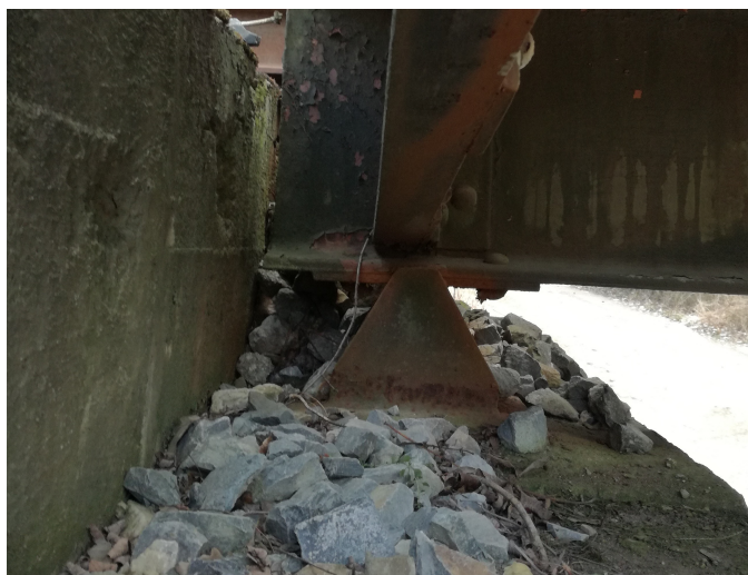
Obr. 7: Posuvné ložisko na opěře O 02
