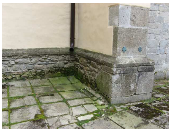
Obr. 29 Kamenný sokl narušen vlhkostí
