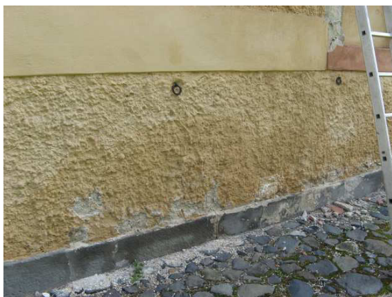
Obr. 19 Fasáda – odlupování povrchových vrstev omítky
