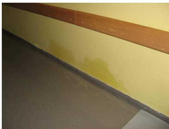
Obr. 15 Viditelná vlhkost v interiéru
