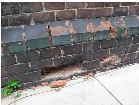
Obr. 14 Degradace keramického obkladu
