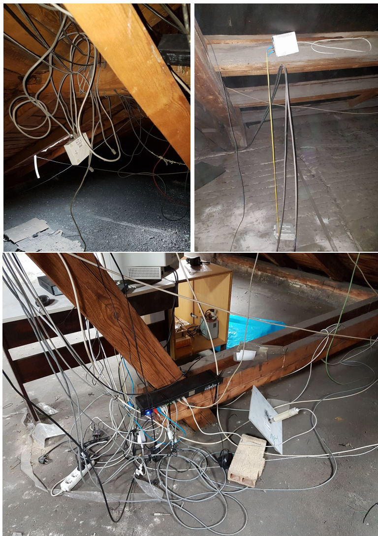
Obr. 8.1: Príklad zlého stavu kabeláže bez zabezpečenia vo voľne prístupných bytových domoch. Autor fotografie: Jan Žejdl, Ostrava 2017
