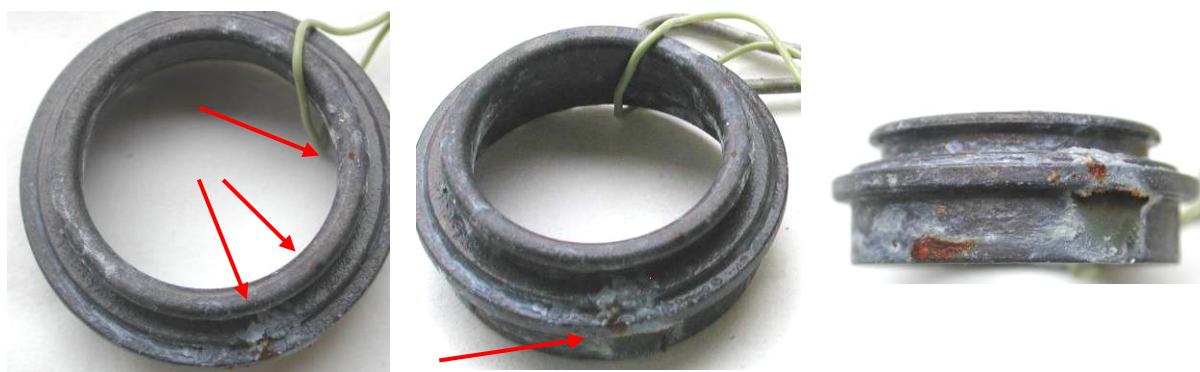
Obrázek 113 - Korozní napadení vzorku N5 bez tepelného namáhání po 1008 h expozice v NSS
