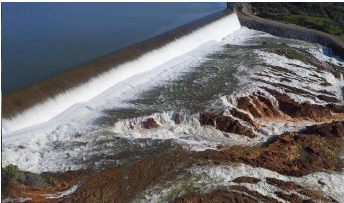
Obr. 4. Postup eroze pod nouzovým přelivem 12. 2. 2017 [8].
