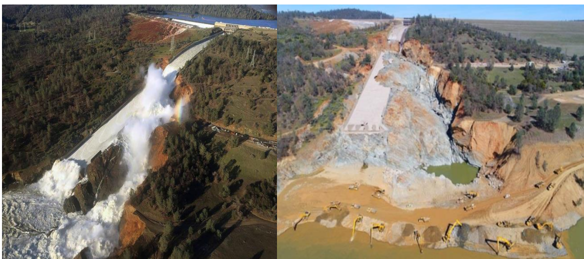
Obr. 5. a) zvýšený průtok přes poškozený skluz 11. 2. 2017 [9]; b) rozsah poškození skluzu na konci povodňové události [8].
