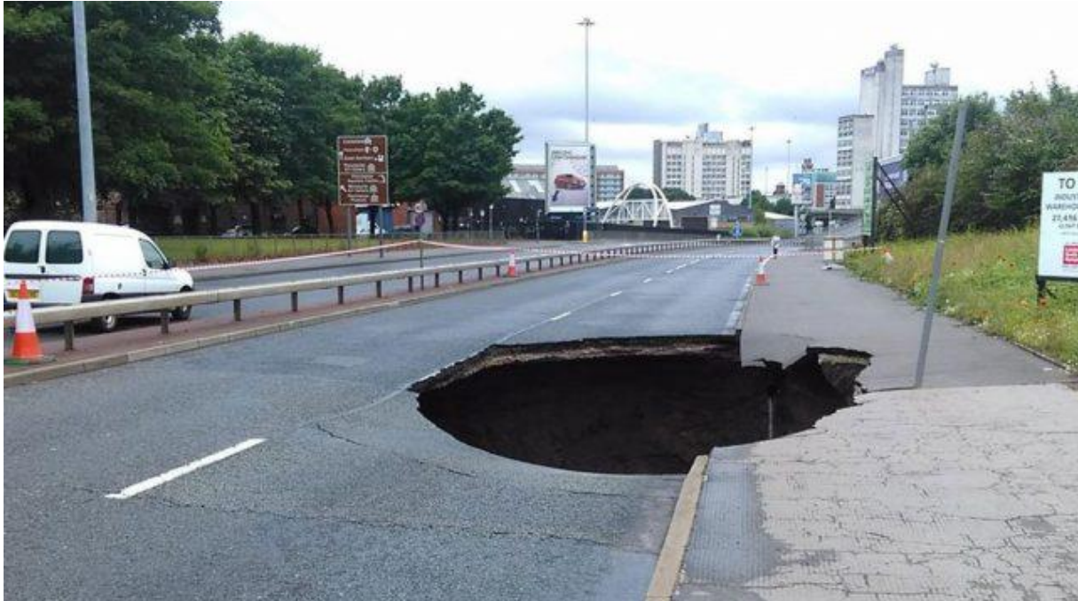
Obr. 9. Netěsné vodovody a netěsné kanalizační stoky vyvolávají vznik kavernózních jevů s intenzifikací jejich vzniku a průběhu otřesy a vibracemi způsobenými dopravním provozem atd.
