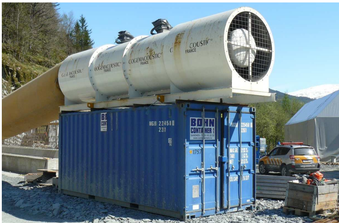
Obr. 2.27: Ventilátorová stanice Cogemacoustic před portálem tunelu [23]
