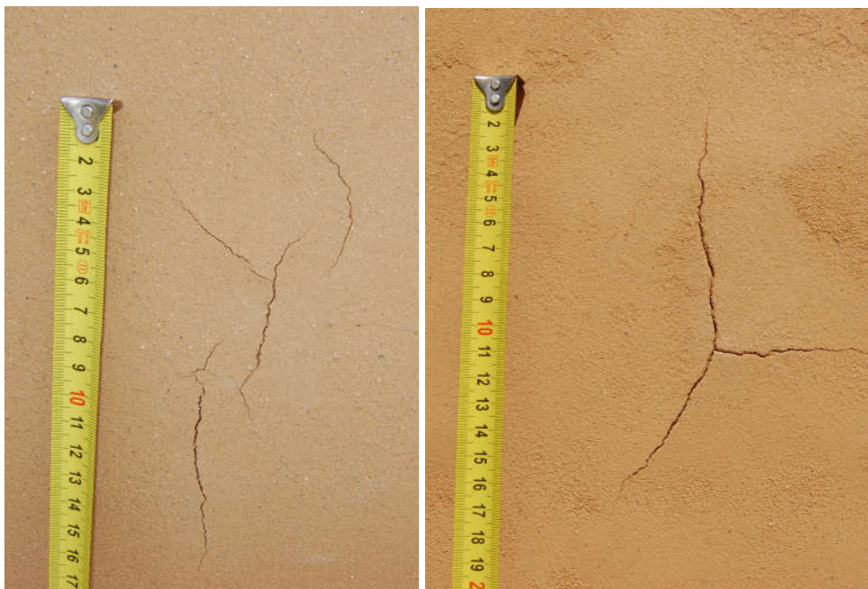
Obrázek 24: Trhliny v povrchu jemných omítek
