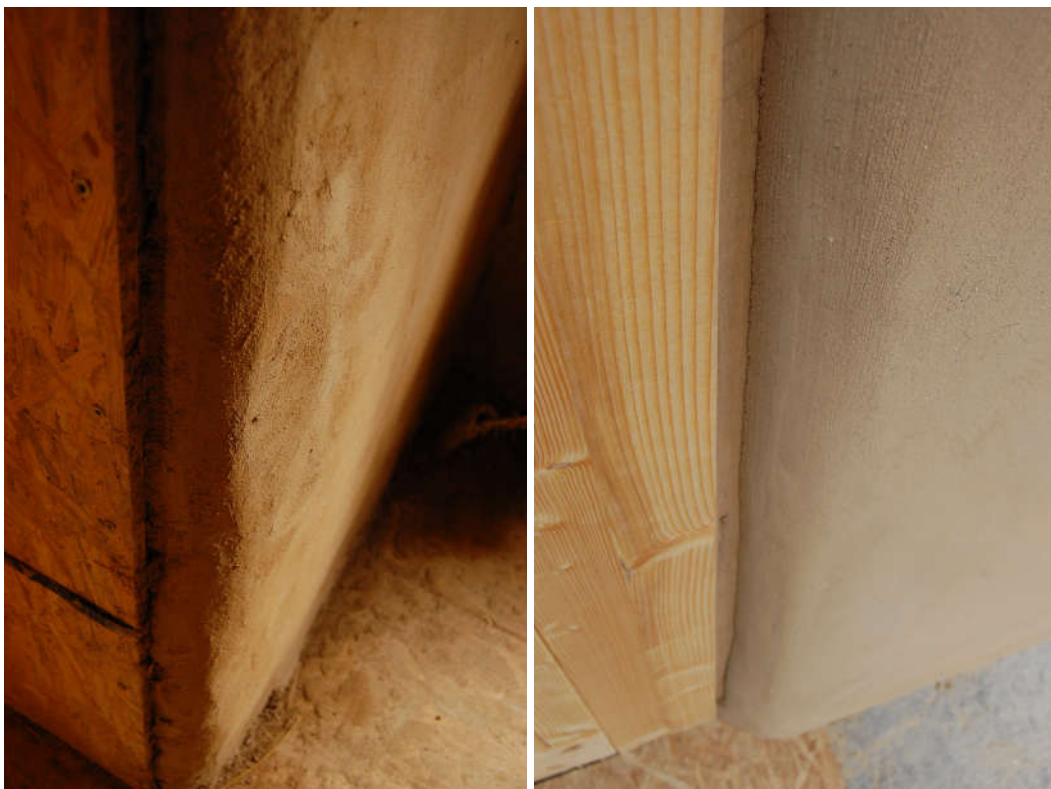
Obrázek 26: Detail svislého ostění dveří v provedení četou AMATER (vlevo) a četou PROFÍ (vpravo)
