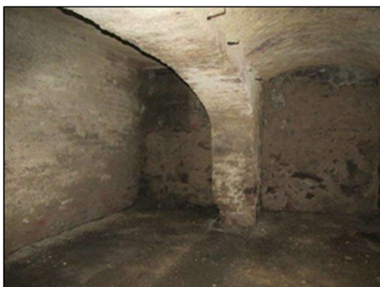
Foto /10/ Vlhkostní poruchy pilířů
