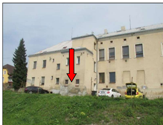
Foto /19/ Jižní strana objektu s vyznačením nejvíce poškozené fasády
