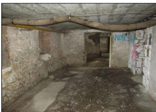
Foto /12/ Vlhkostní poruchy v suterénu
