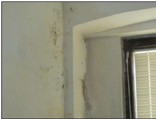
Foto /4/ Vlhkost u nadpraží okna
