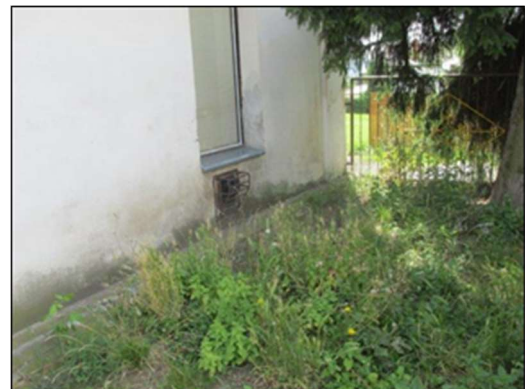
Foto /17/ Výkvěty solí v úrovni podlahy
