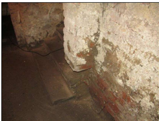
Foto /8/ Vlhkostní poruchy zdiva v 1.PP
