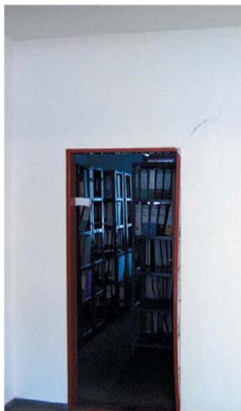
Obr. 4.2 Příklad trhliny ve zděné příčce s dveřním otvorem [1]
