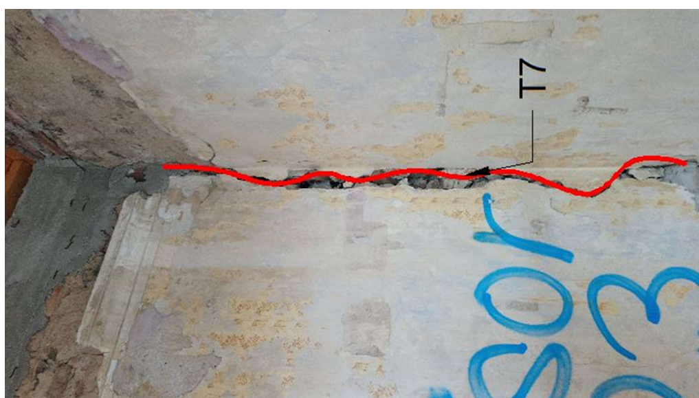
Obrázek 26– fotodokumentace trhlin T1, T4 a T6 a svislých trhlin T7 a T8
