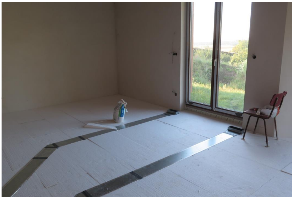
Obr.č.20 Rozvody v podlaze
