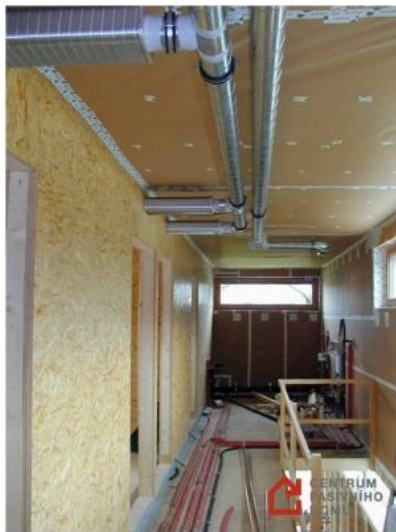
Obr.č.19 Rozvody pod stropem [12]
