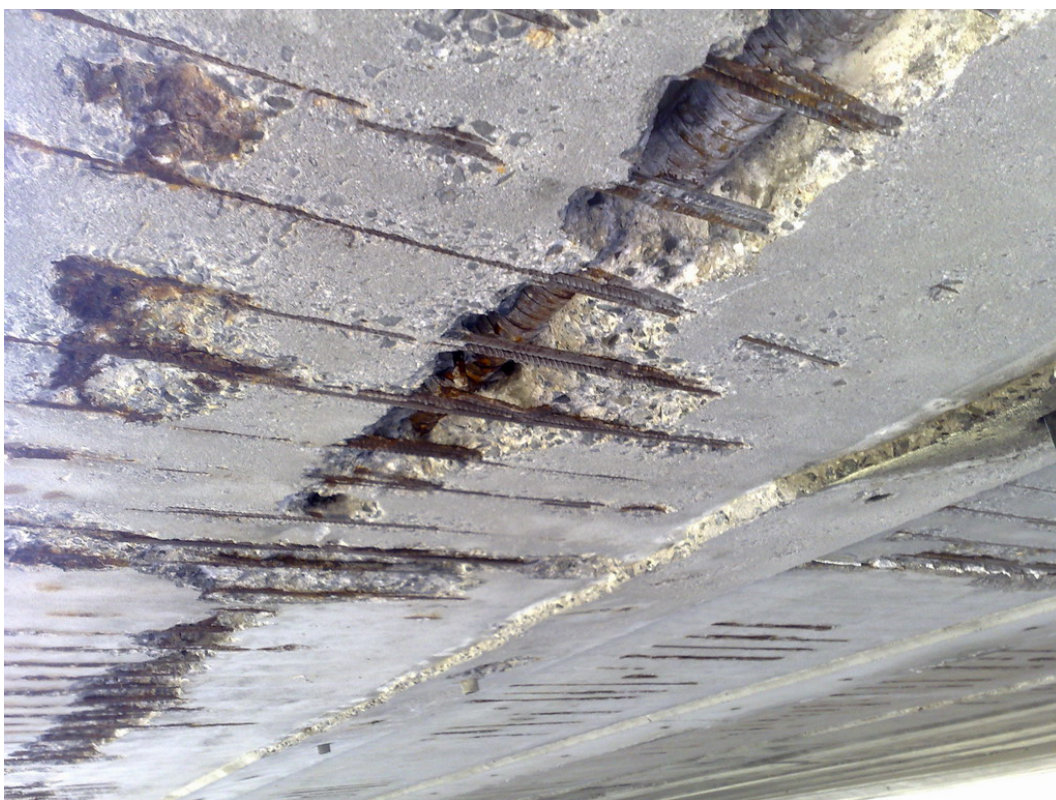
Obrázek č. 15: Příklad betonové konstrukce před sanací [26]
