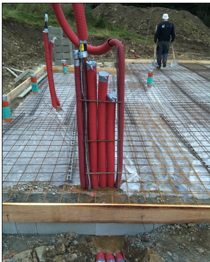
Obrázek 18 - Vyústění elektro chrániček (zdroj autor)
