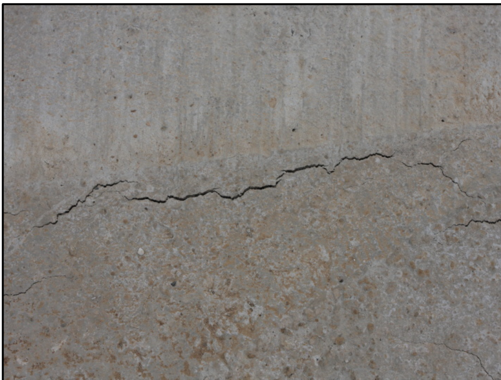
Obrázek 36 - Prasklina v betonové desce (zdroj https://forum.tzb-info.cz/107316-zakladova-deska-praskliny )
