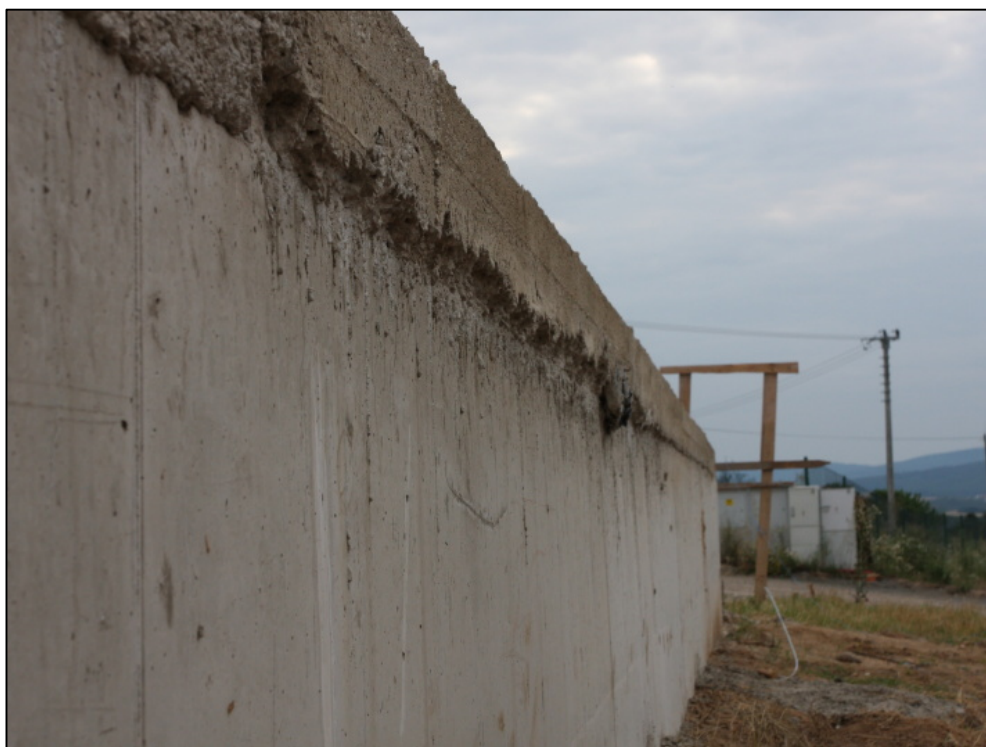
Obrázek 37 - Přesah betonové desky (zdroj https://forum.tzb-info.cz/107316-zakladova-deska-praskliny )
