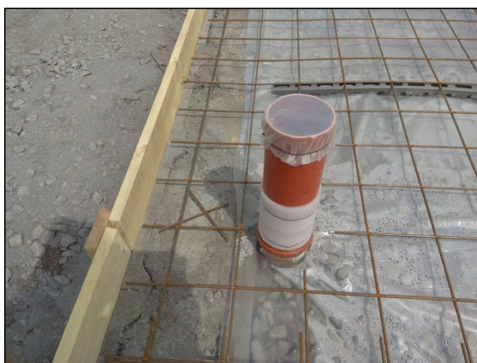
Obrázek 29 - Kanalizační prostup obalen mirelonem (zdroj autor)
