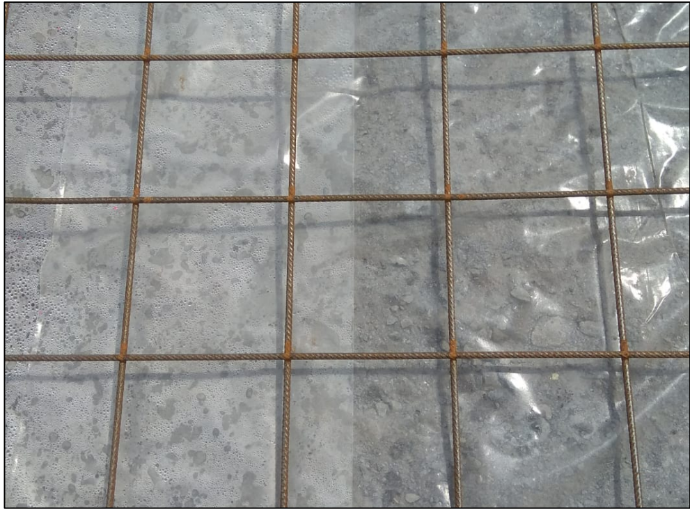
Obrázek 38 – Nedostateční krytí výztuže (zdroj autor)
