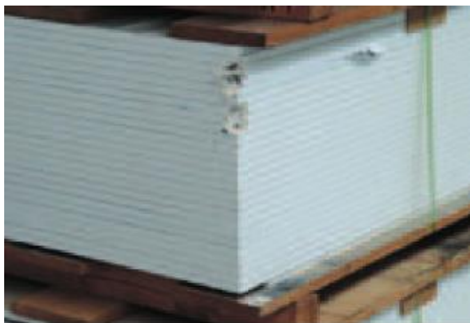
Obr. 9: Poškození rohů desek
